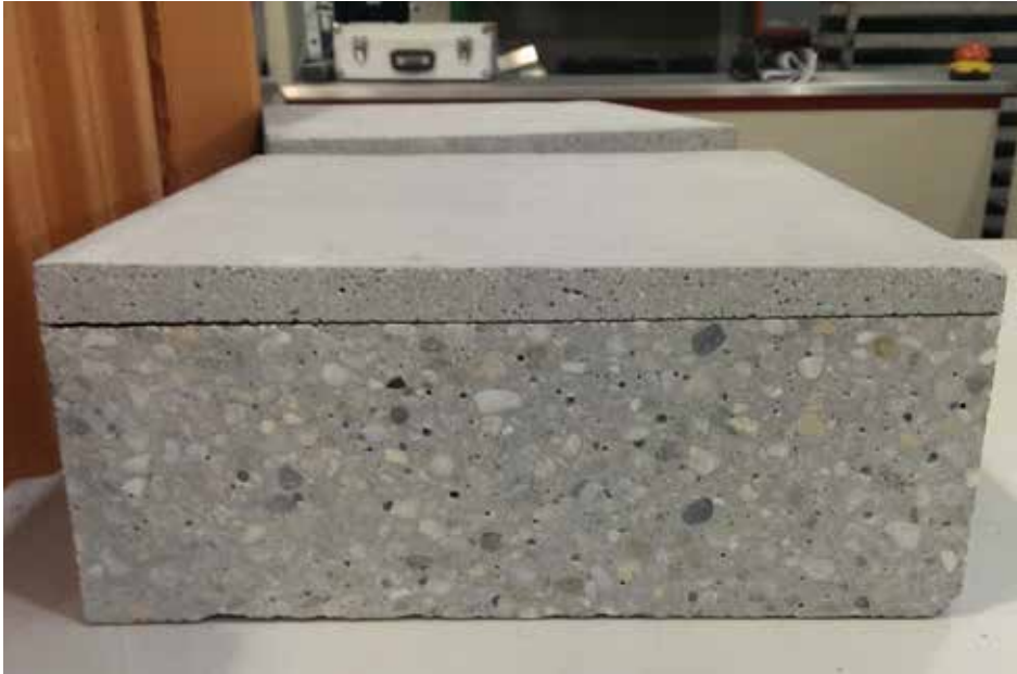
Pucanje veze između slojeva ugradnje zbog većih čvrstoća u završnom sloju nego u podložnom.
